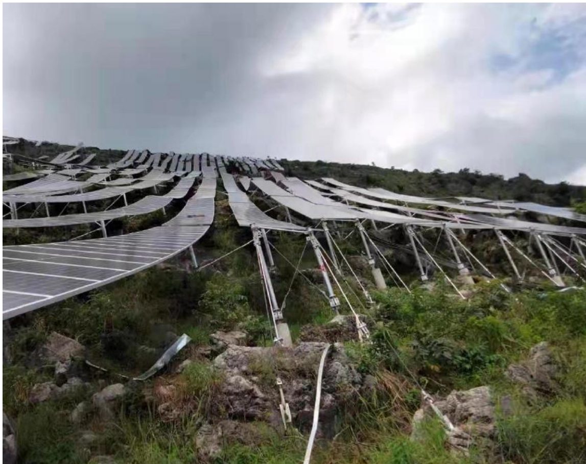
中国·贵州 7MW 柔性支架
