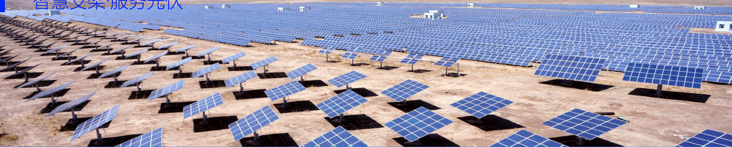
中国·共和 100MW 跟踪+地面支架
