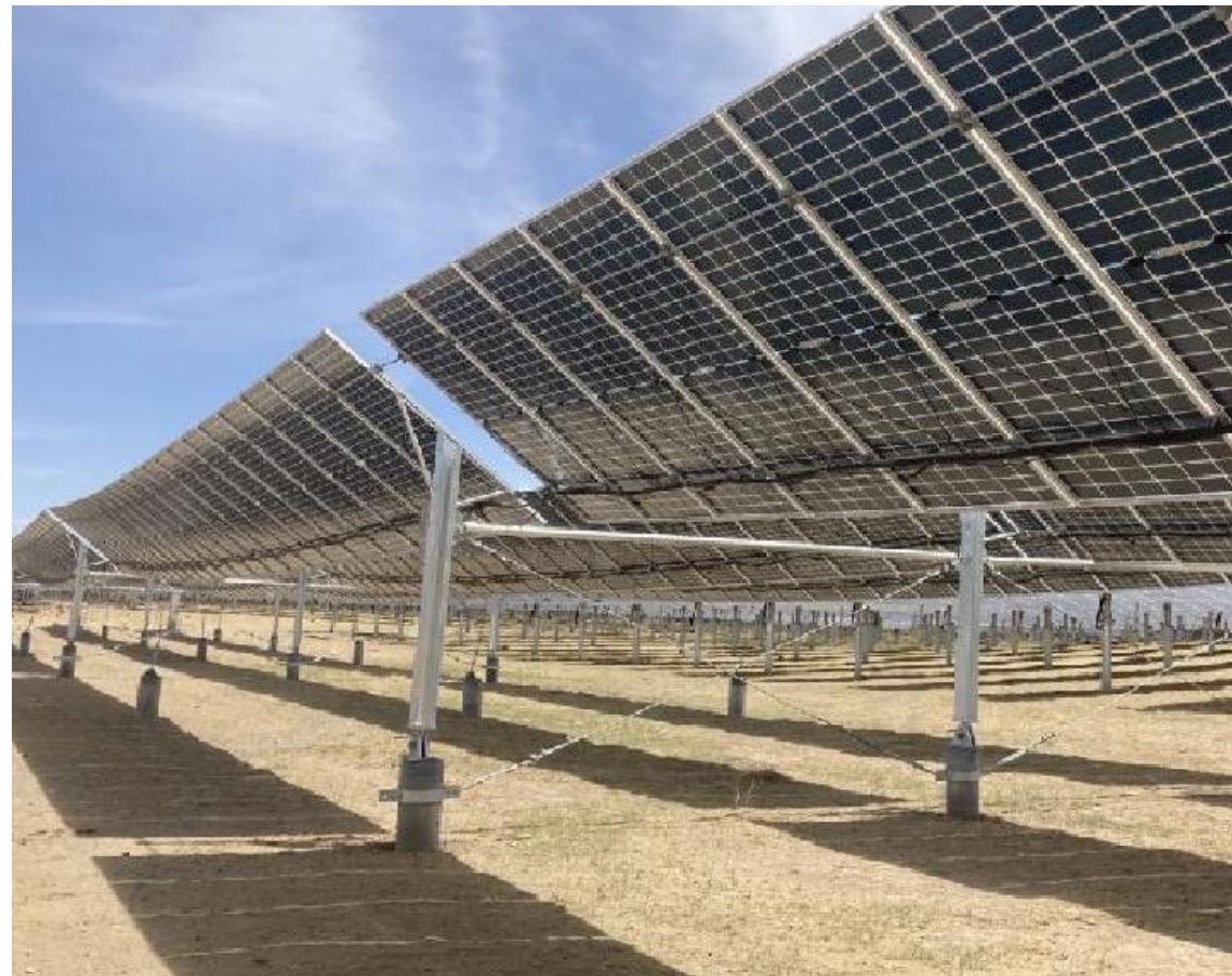
中国·海南州 150MW 柔性支架
